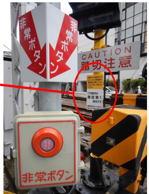
踏切非常ボタン
